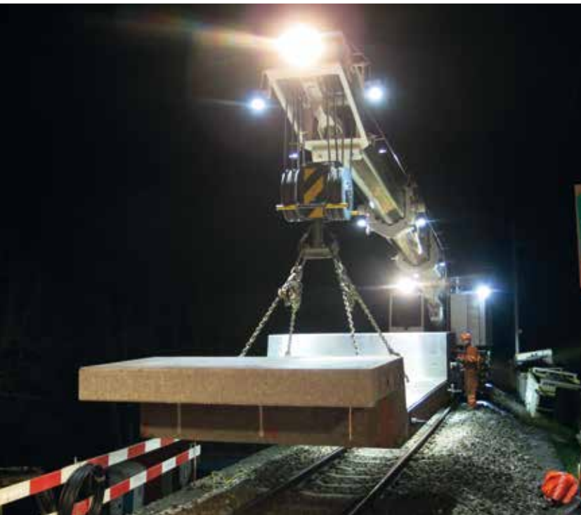
Einbringen und Vorspannen Schottertrug Assembling and pretensioning of pre cast ballast hutch
